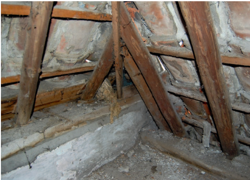
Onbeschoten kap, de mortel van de aangestreeken pannen valt plaatselijk weg.
